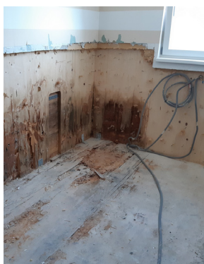
Abb. 1: Feuchteschaden im Holzmassivbau
