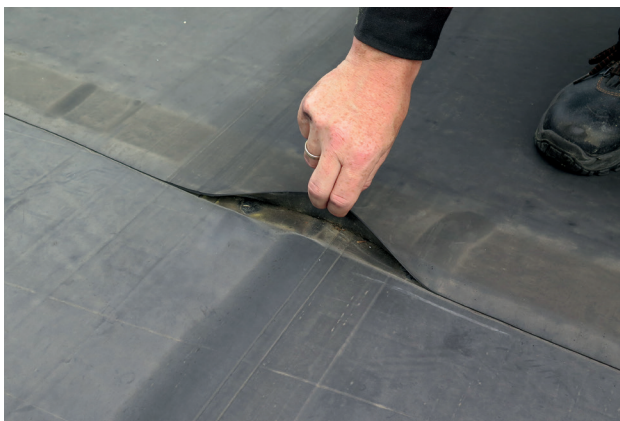
Defekte Schweißnaht an der Abdichtungsüberlappung.
