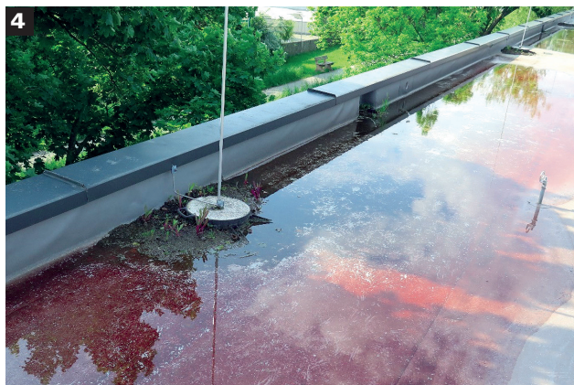
Lackenbildung aufgrund eines verstopften Gullys.
