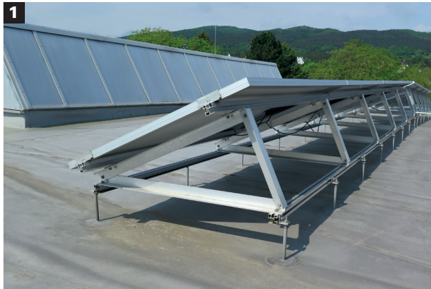
offenes PV-Modul ohne Windleitblech
