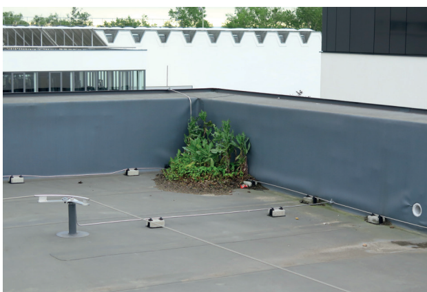
Unerwünschter Bewuchs auf der Dachfläche führt zu kritischen Klimabedingungen auf der Dachbahn.
