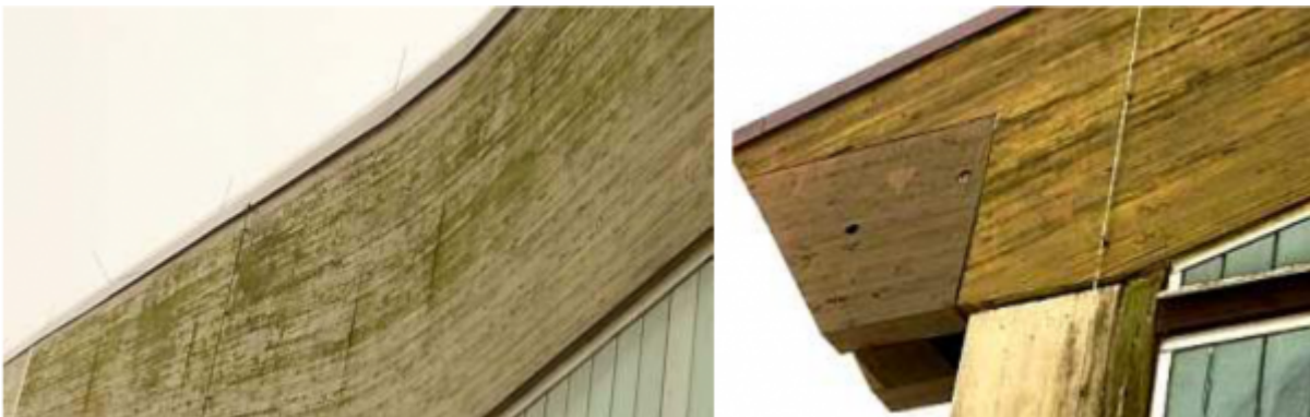
Abb. 1: abgewitterte Randträger; Veralgungen und zu erneuernder Anstrich
