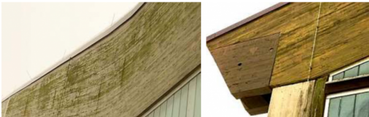
Abb. 1: abgewitterte Randträger; Veralgungen und zu erneuernder Anstrich
